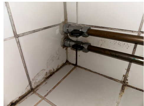
Stoppekran plassert på bad
