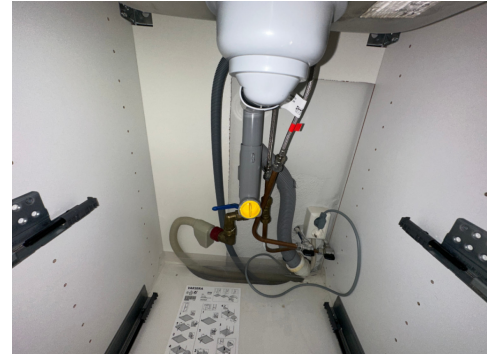
Rørproppleg i kjøkkenbenk
