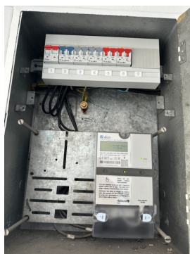
Sikringsskap med automatsikringer.
