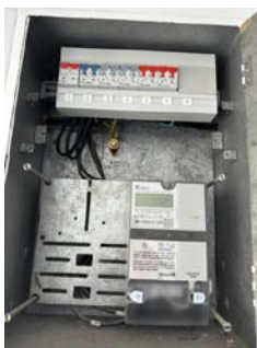
Sikringskap med automatsikringer.
