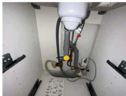
Røropplegg i kjøkkenbenk
