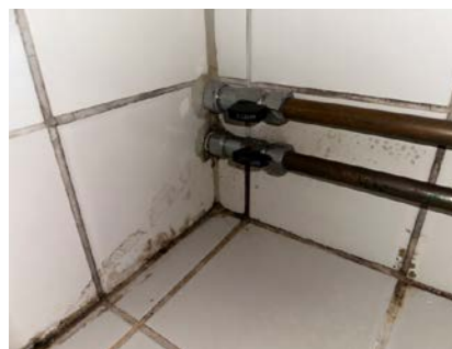
Stoppekran plassert på bad
