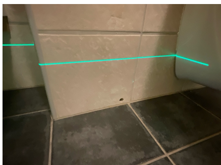
Avrenning fra innebygd toalettkasse.
