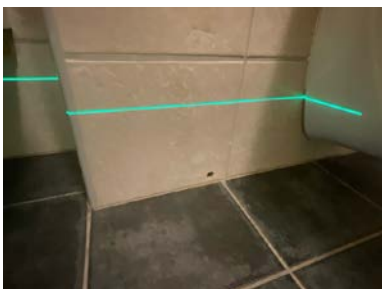
Avrenning fra innebygd toalettkasse.
