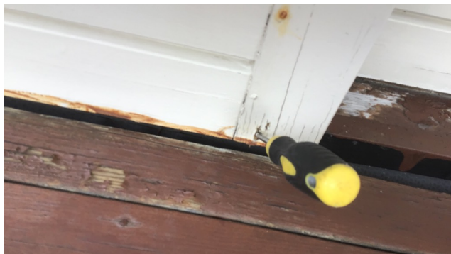
Fukt/råte i nedkant skyvedør
