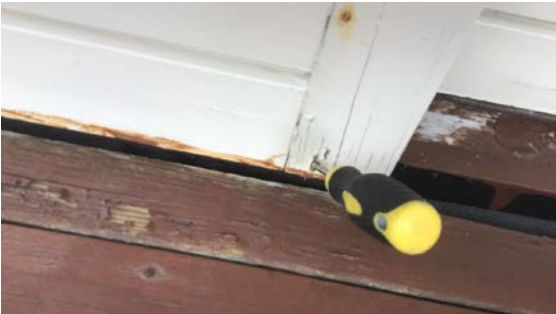
Fukt/råte i nedkant skyvedør
