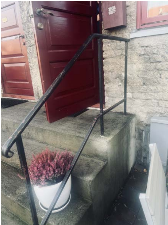
Utvendige trapper. Rekkverk tilfredsstill ikke dagens krav til rekkverk/fallsikring.
