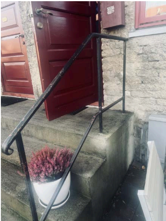
Utvendige trapper. Rekkverk tilfredsstillers ikke dagens krav til rekkverk/fallsikring.
