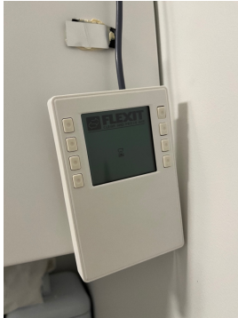
Betjeningspanel på siden av ventilasjon
