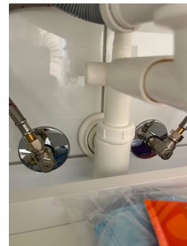
Avløp i plast under servant på bad
