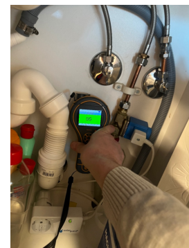
Avløp i plast under kjøkkenbenk
