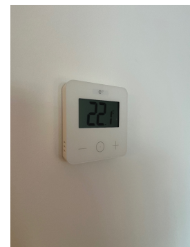
Betjeningspanel til vannbåren varme
