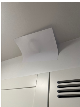
Avtrekk fra balansert ventilasjon
