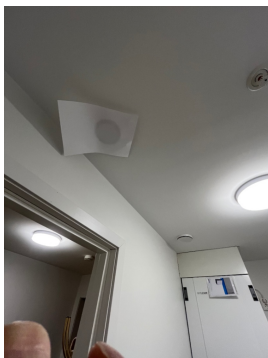
Avtrekk ved dør, tilluft på andre siden av rommet ved aggregat.
