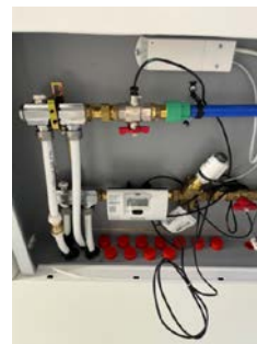
Styring for vannbåren varme i tak på bad.
