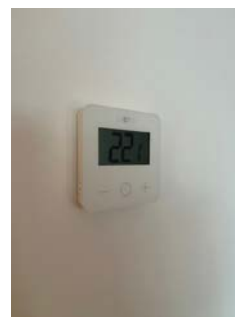
Betjeningspanel til vannbåren varme
