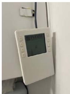
Betjeningspanel på siden av ventilasjon
