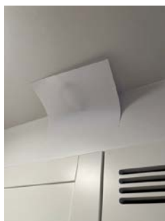
Avtrekk fra balansert ventilasjon
