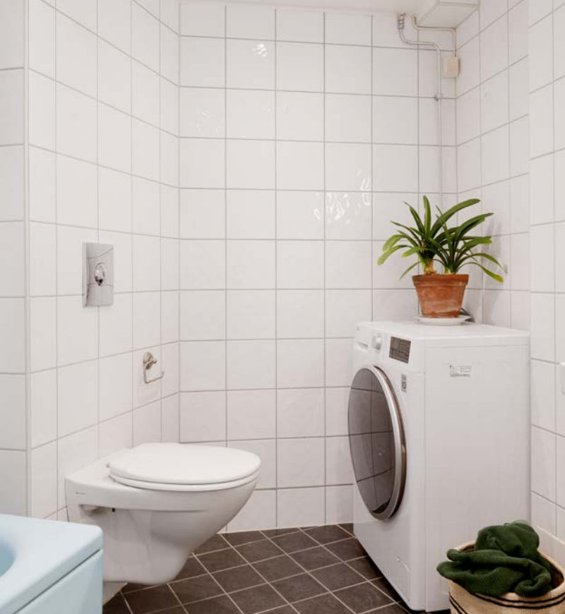
Her er det downlights i tak og varmekabler i gulv.
