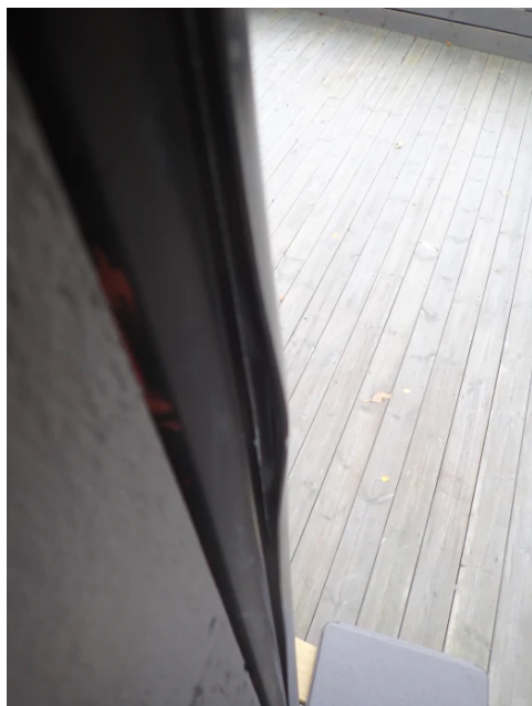
Deformasjon i nedløpsrør.
