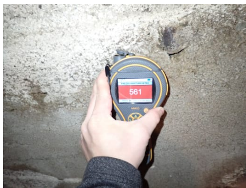
Fuktmåling oppe på vegg på grunnmur.
