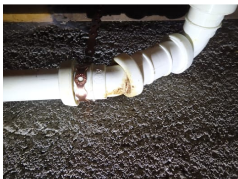
Misfarging ved rørmuffe.
