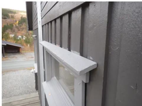
Vannbrett som ikke er trekt innunder kledning.
