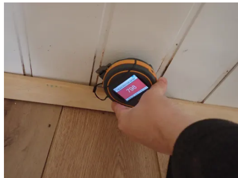
Fuktskader i påforet vegg i tilbygg.
