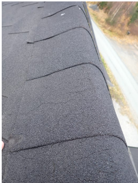
Tegn på mindre riss i overflaten på papp.
