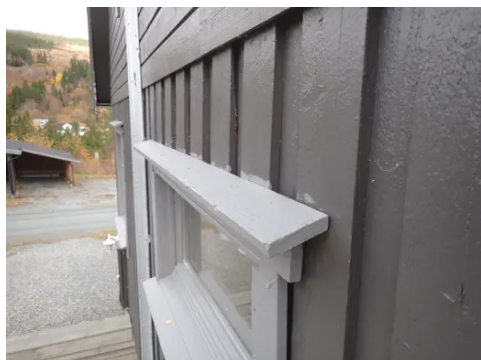
Vannbrett som ikke er trekt innunder kledning.
