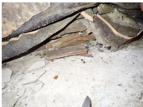
Råteskader i treverk mot grunnmur/gulv.
