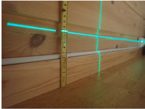
Referansenivå laser = 40 mm. Viser avvik på ca. 70 mm i bod i 1. etasje.
