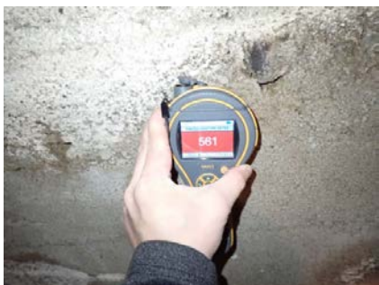
Fuktmåling oppe på vegg på grunnmur.
