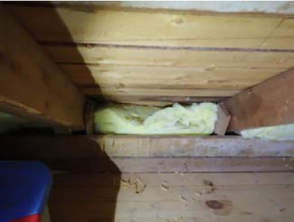
Begrenset/dårlig lufting ved raft.
