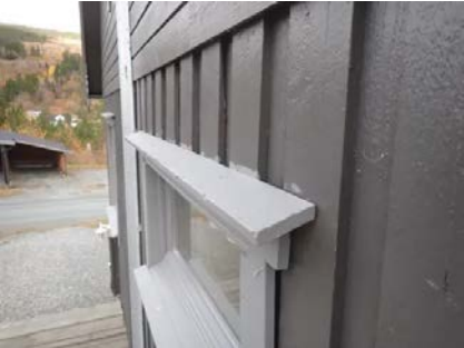
Vannbrett som ikke er trekt innunder kledning.
