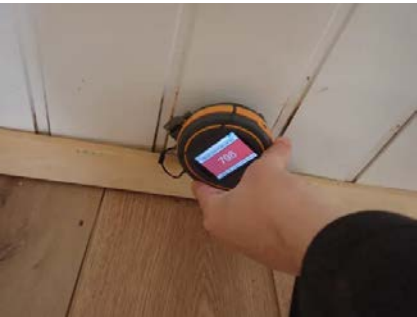
Fuktskader i påforet vegg i tilbygg.
