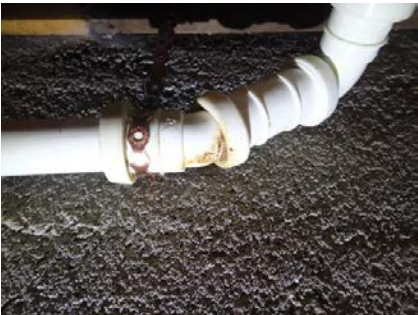
Misfarging ved rørmuffe.
