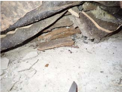
Råteskader i treverk mot grunnmur/gulv.
