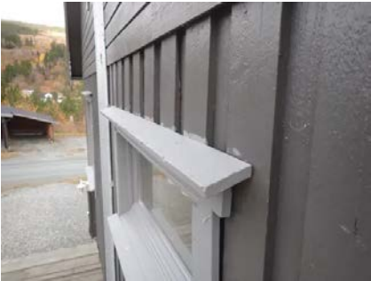
Vannbrett som ikke er trekt innunder kledning.
