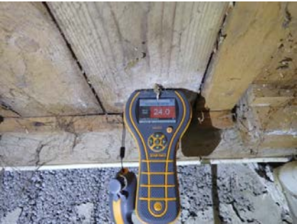
Risiko for skadeutvikling i etasjeskiller, fra underetasje.
