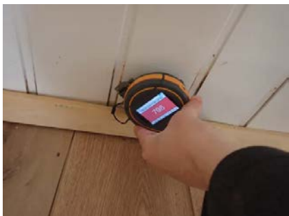
Fuktmåling på utforet vegg i tilbygg.
