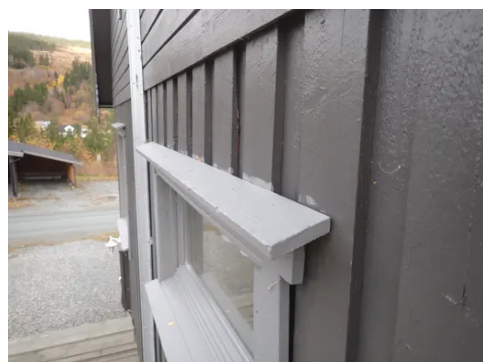
Vannbrett som ikke er trekt innunder kledning.
