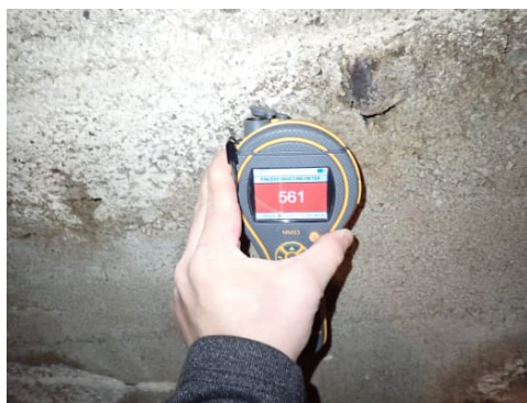
Fuktmåling oppe på vegg på grunnmur.
