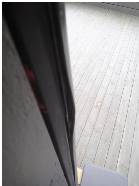
Deformasjon i nedløpsrør.
