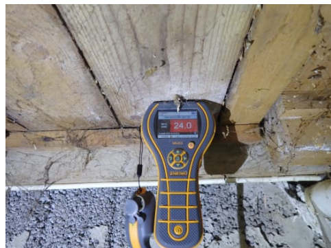
Fare for utvikling av råte i bjelkelag, samt tegn på muggvekst.
