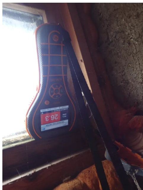
Høyt fuktnivå i vindu med høy risiko for råteutvikling.
