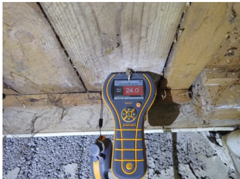
Risiko for skadeutvikling i etasjeskiller, fra underetasje.
