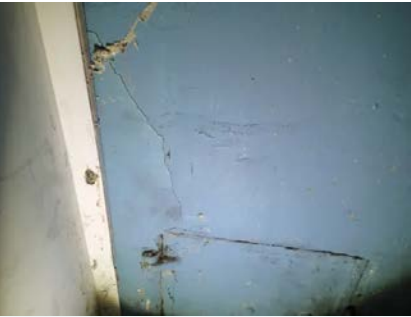
Sprekker i pipemur.
