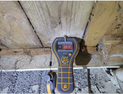
Fare for utvikling av råte i bjelkelag, samt tegn på muggvekst.
