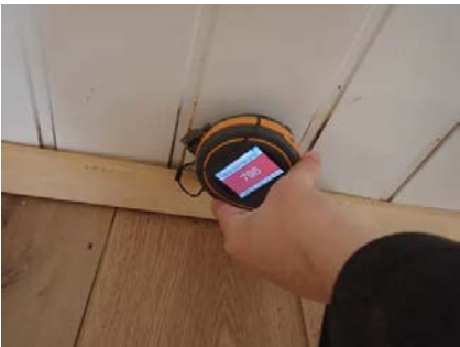
Fuktmåling på utforet vegg i tilbygg.
