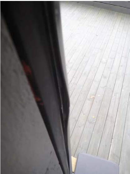
Deformasjon i nedløpsrør.
