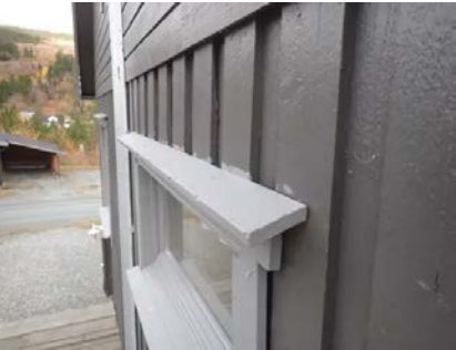
Vannbrett som ikke er trekt innunder kledning.
