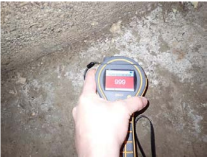
Fuktmåling på gulv.
