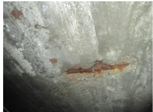
Noe synlige armeringsjern.
