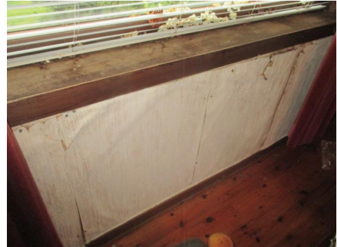
Tapet er løsnet/skadet.
