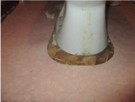
Gulvbelegget dekker ikke i rundt toalettet
