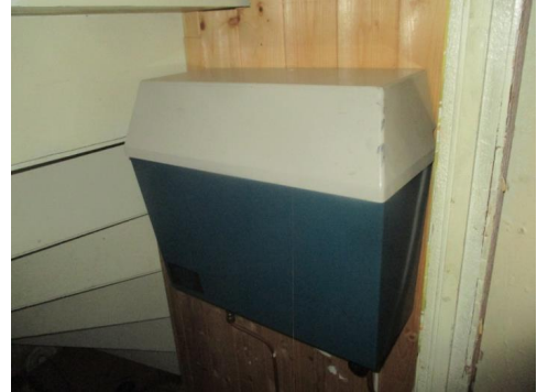
Dagtank i trappegangen til grovkjeller.
