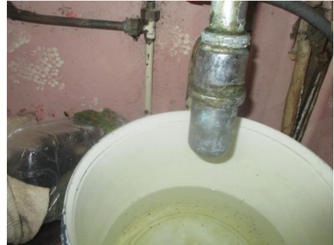
Lekkasje på bad/vaskerom.
