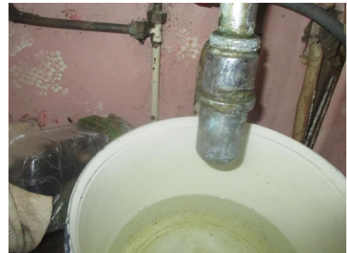
Lekkasjer ved servant.
