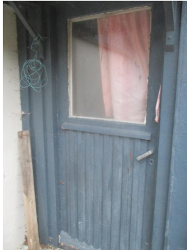
Ytterdør til kjeller trenger noe vedlikehold
