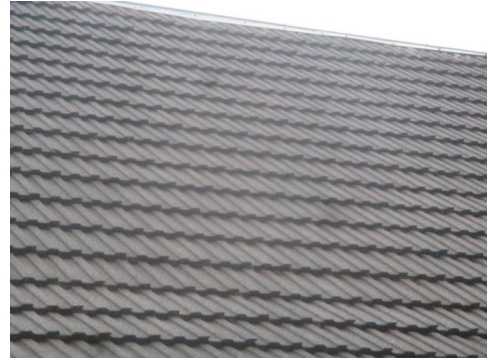
Deler av taktekkingen på ene siden.
