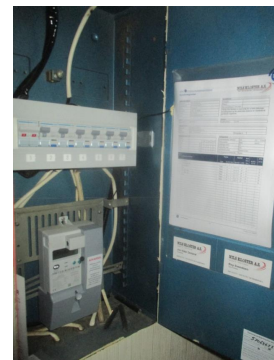
Sikringsskapet er plassert i trappegangen til loftet.
