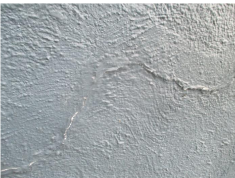
Eldre sprekker som er blitt fuget igjen.
