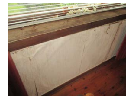
Tapet er løsnet/skadet.
