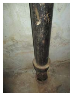
Eldre avløpsrør i kjellergulvet og ut av boligen.
