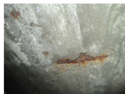
Noe synlige armeringsjern.
