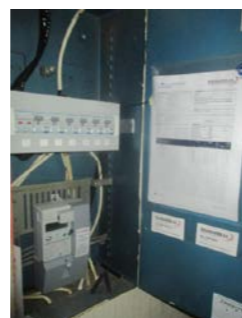
Sikringsskapet er plassert i trappegangen til loftet.
