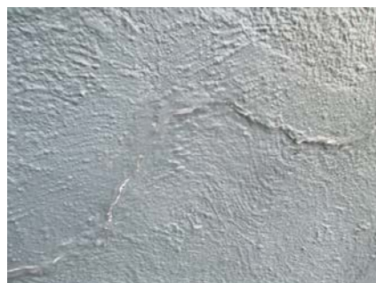
Eldre sprekker som er blitt fuget igjen.
