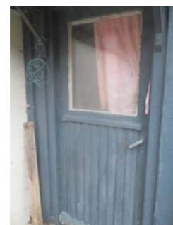
Ytterdør til kjeller trenger noe vedlikehold
