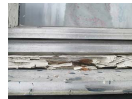
Råteskader på flere vinduer.
