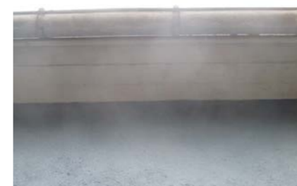
Ingen tilgang på luft i gesimser.
