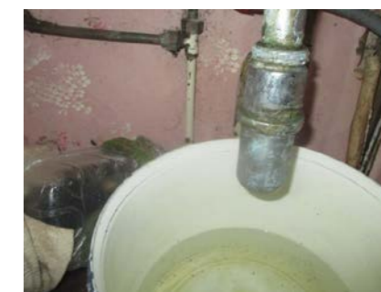
Lekkasjer ved servant.
