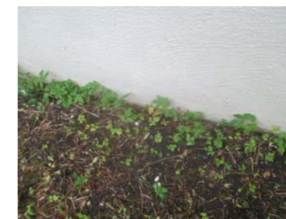
Ingen synlig fuksikring av grunnmur.
