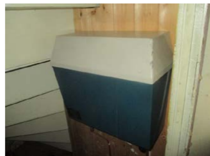
Dagtank i trappegangen til grovkjeller.
