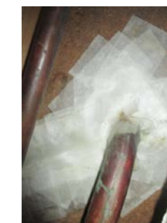
Har vært noe fukt i rundt rørgjennomføring.
