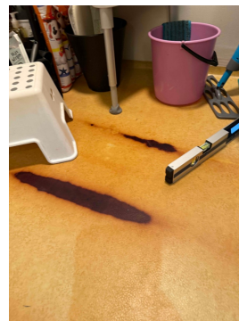
Bildet viser varmeskade på gulvbelegg.
