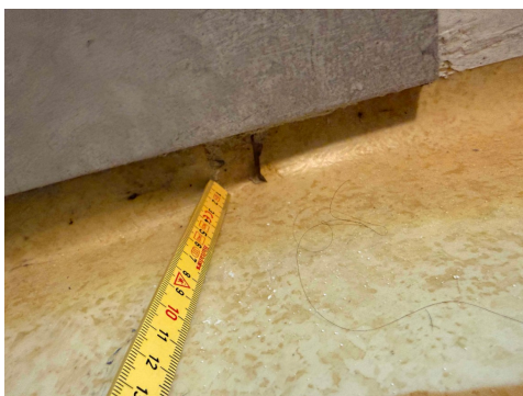
Bildet viser sprekke i gulvbelegget.
