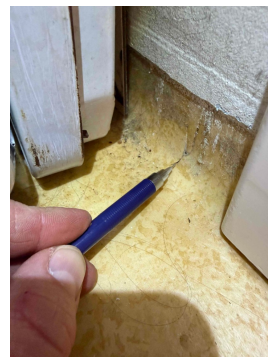
Bildet viser sprekke i gulvbelegget.
