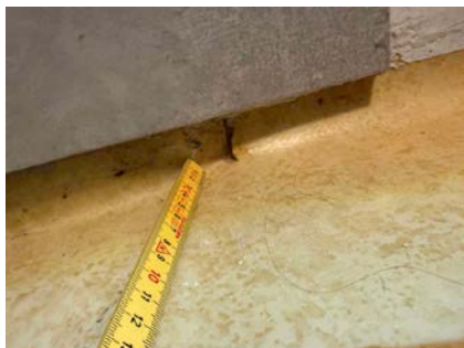
Bildet viser sprekk i gulvbelegget.
