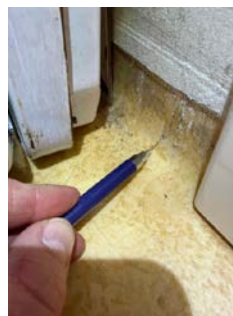
Bildet viser sprekk i gulvbelegget.
