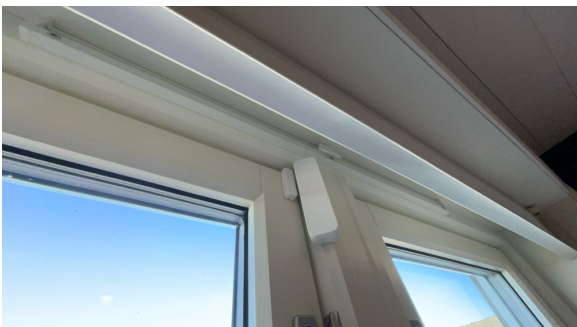
Eksempel på montert ventil i vindu.
