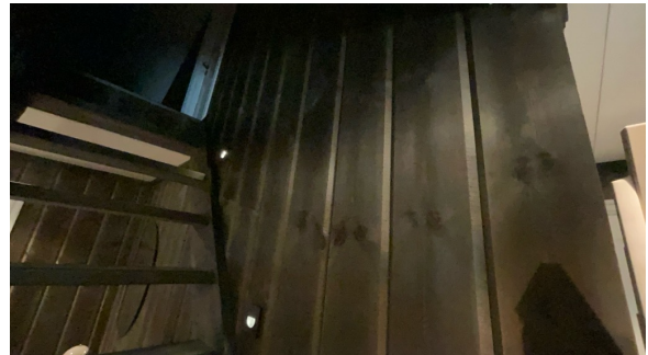
Det er ikke montert veggerekke.
