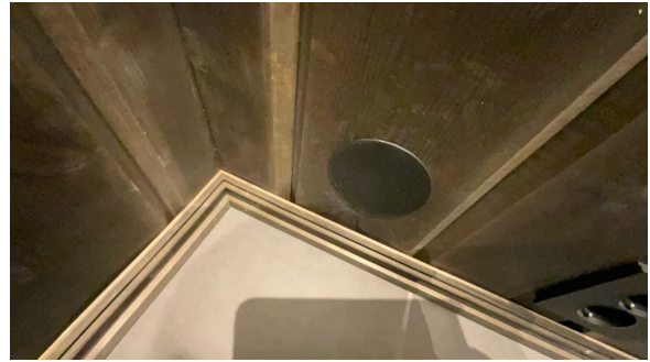
Lokk over hull.
