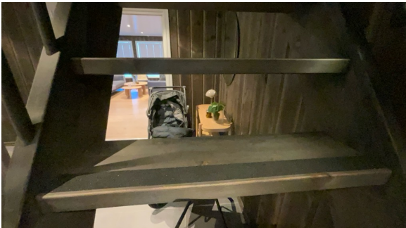
Åpning mellom trinn som overstiger 10 cm.
