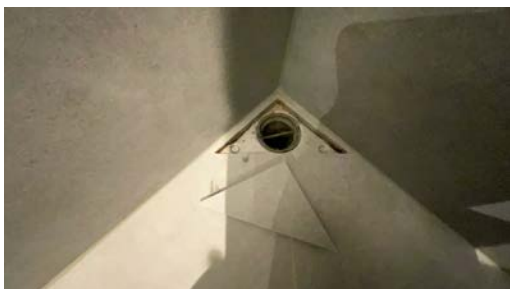
Sluk i gulv.
