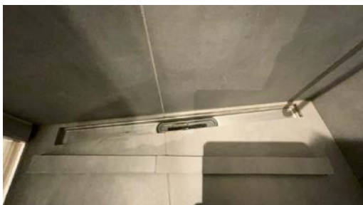
Sluk i gulv.
