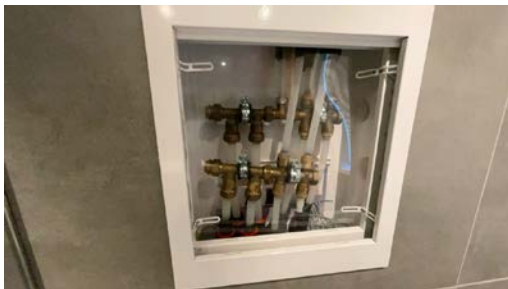
Skap til rør i rør system.
