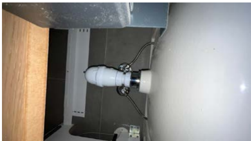
Del av rør til avløp.
