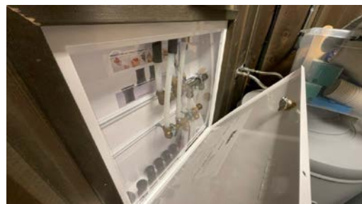
Skap til rør i rør system.
