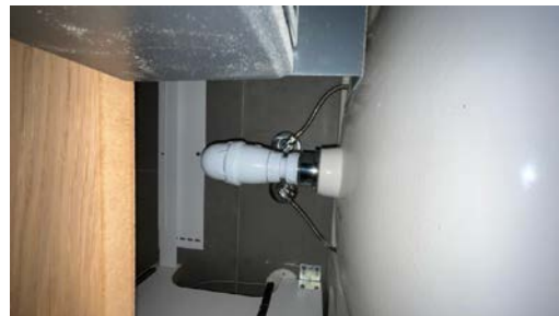
Del av rør til vann.
