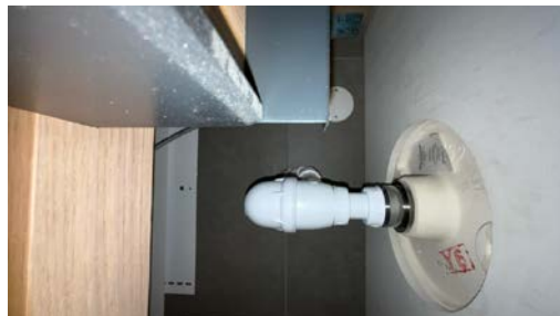
Del av rør til avløp.
