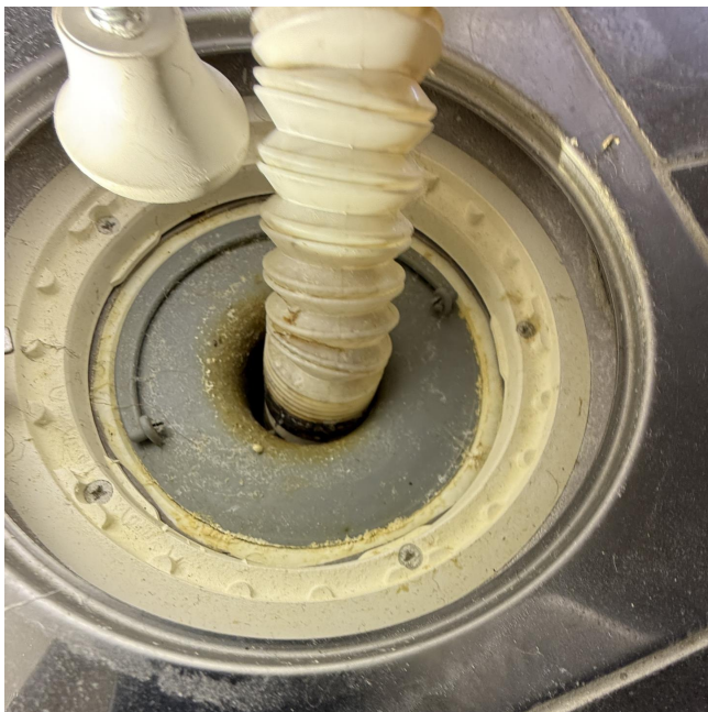
Sluk, bad 2 etasje
