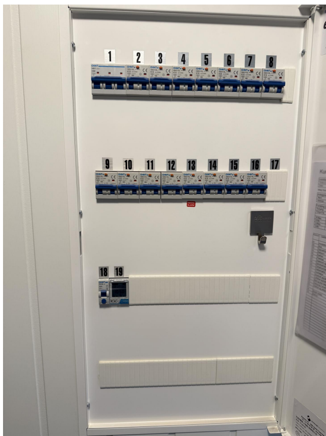
Sikringsskap plassert i vaskerom 1 etasje vegg nord
