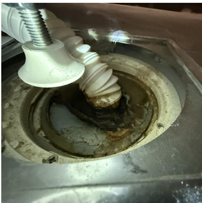
Sluk under dusjkabinett
