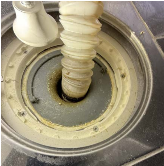
Sluk, bad 2 etasje
