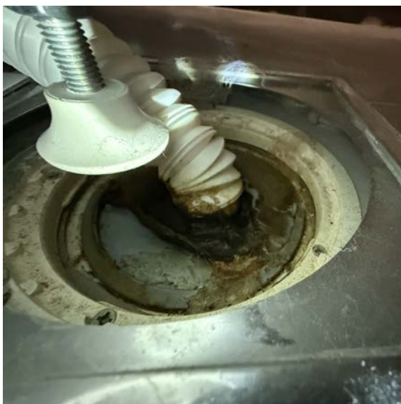
Sluk under dusjkabinett
