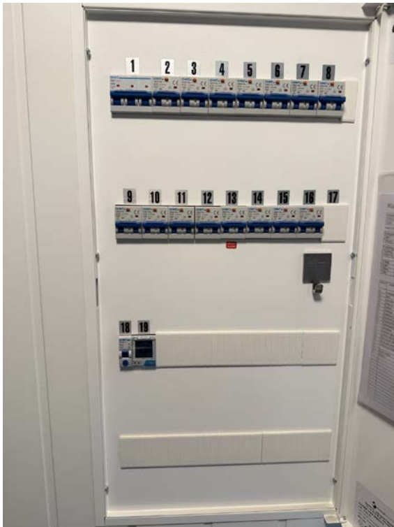
Sikringsskap plassert i vaskerom 1 etasje vegg nord
