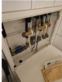
Manglende drenering fra fordelerskap.
