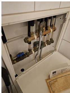
Manglende drenering fra fordelerskap.
