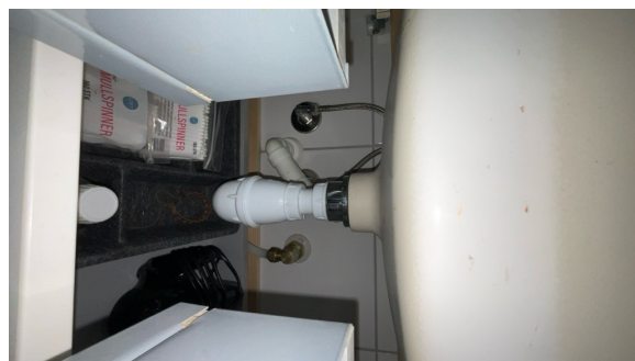
Del av rør til vann.
