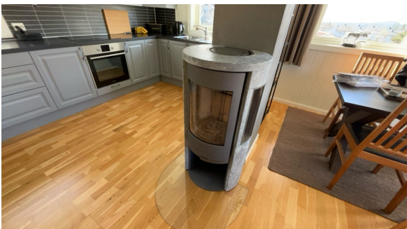
Montert ovn i Kjøkken/stue.
