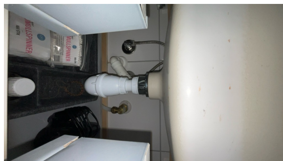
Del av rør til avløp.
