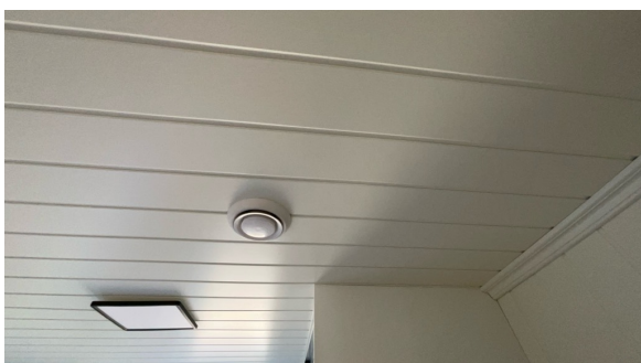
Eksempel på montert ventil i tak.
