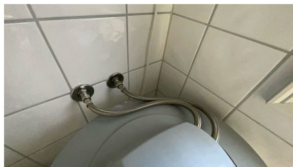
Del av rør til vann.
