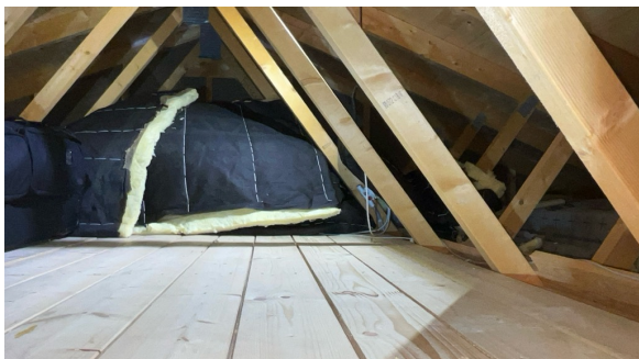
Aggregat til balansert ventilasjon på loft.
