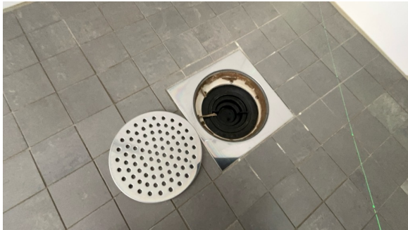
Sluk i gulv.
