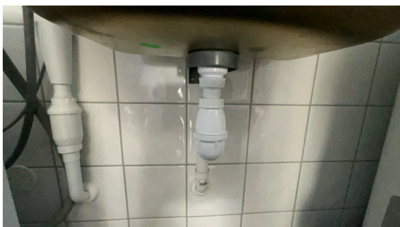
Del av rør til avløp.
