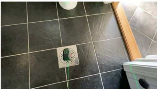
Målt fall på gulv.
