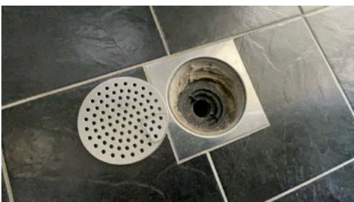
Sluk i gulv.
