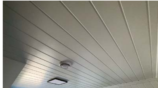
Eksempel på montert ventil i tak.
