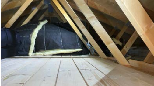
Aggregat til balansert ventilasjon på loft.
