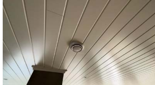
Eksempel på montert ventil i tak.
