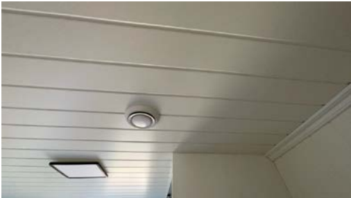
Eksempel på montert ventil i tak.
