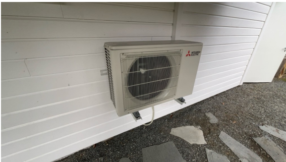
Varmepumpe, utvendig aggregat.
