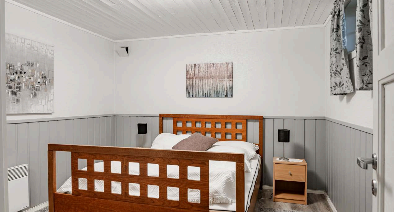
Rom i kjeller innredet som soverom 4. Det gjøres oppmerksom på at rommet ikke er godkjent for varig opphold.
