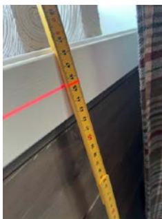
Målt høyde på 45,5 cm, avvik på 20 mm på rommet
