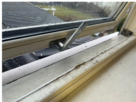
Loftsvindu med slitasje og skade på tetningslist.
