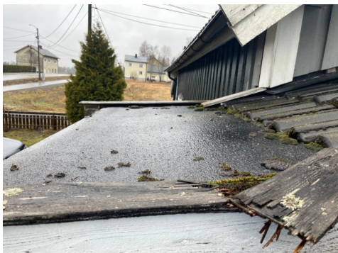
Råteskade i toppbord.
