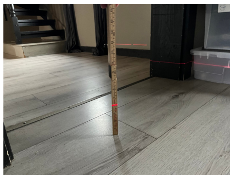
Måling i åpning til stue viste høydeforskjell på 70 mm.
