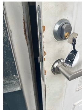
Ytterdør med merker og slitasje.
