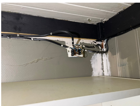
Åpen koblingsboks over kjøkkenskap.
