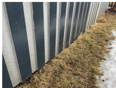
Kledning er ført ned til terreng og overflatebehandling er ikke fullført.
