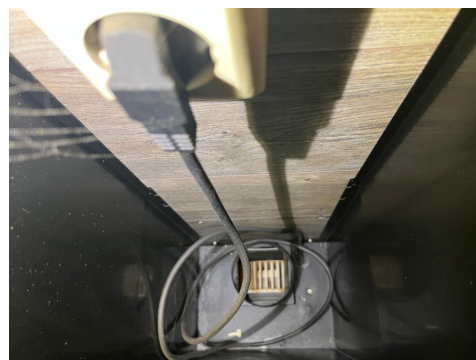
Bilde ned til ventilator viser at det ikke er montert avtrekkskanal.
