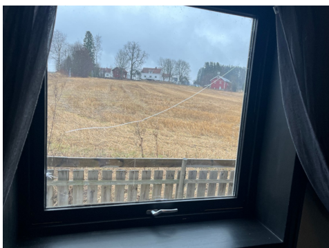
Sprekk i kjøkkenvindu.
