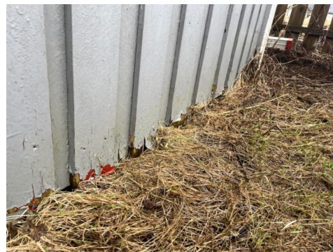
Trekledning har råteskader.
