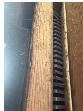
Bilde underkant av kledning viste musebånd.
