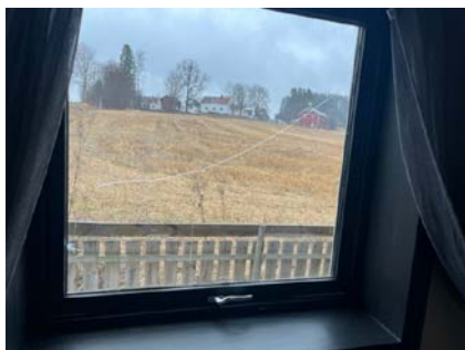
Sprekk i kjøkkenvindu.
