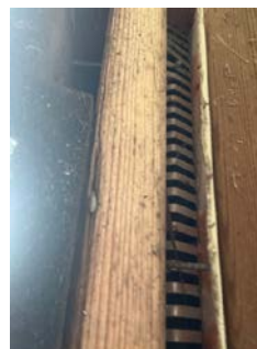
Bilde underkant av kledning viste musebånd.
