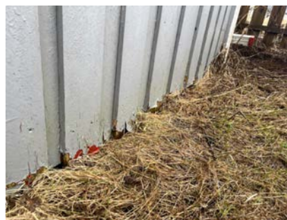
Trekledning har råteskader.
