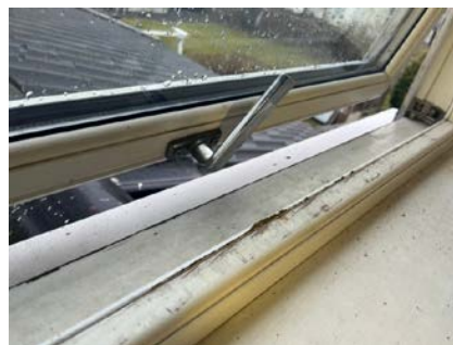
Loftsvindu med slitasje og skade på tetningslist.
