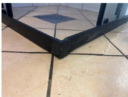
Vannet viste at bruksvann rant ut av dusjsone.
