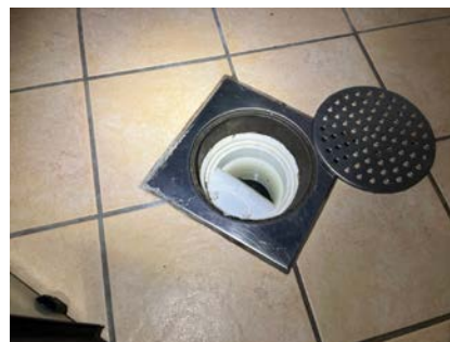
Sluk i dusjsone.
