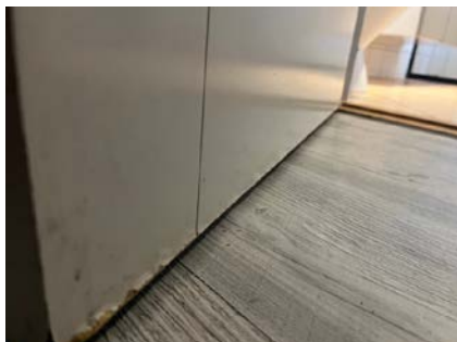
Dør til bad har fuktskader.
