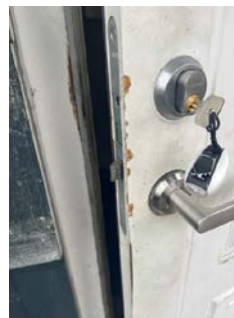
Ytterdør med merker og slitasje.
