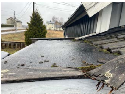
Råteskade i toppbord.
