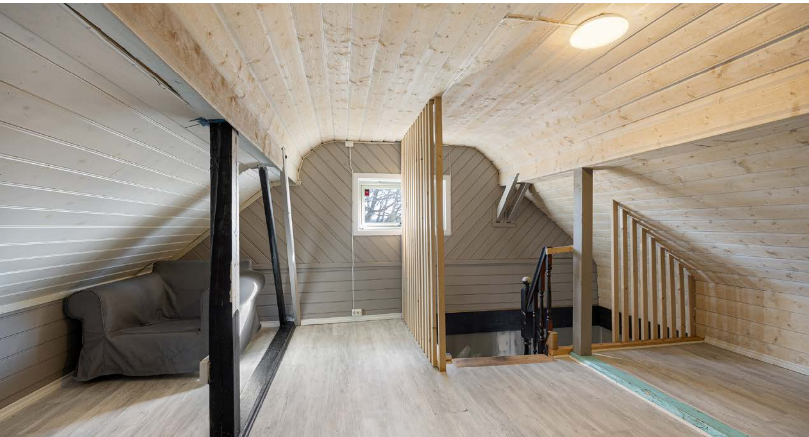
Loftsetasjen består av to store disponible rom. Rommene er ikke godkjent brukt som oppholdsrom.
