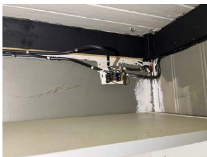
Åpen koblingsboks over kjøkkenskap.
