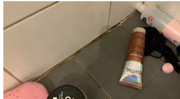
Sprekker og missfarging i silikofuger.
