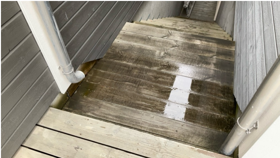
Takvannet ledes ikke vekk fra bygningen.
