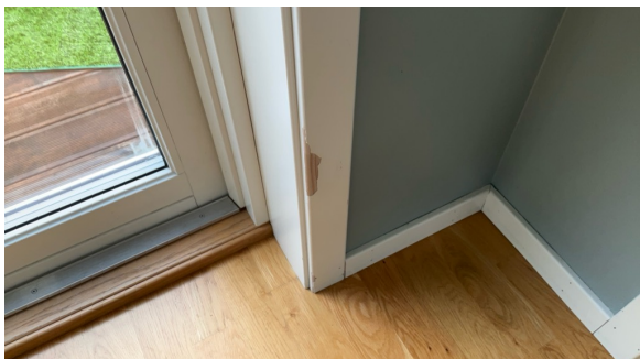
Slitasje på lister.
