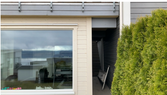
Deler av kledningen mangler overflatebehandling.
