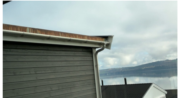
Rust på beslag.
