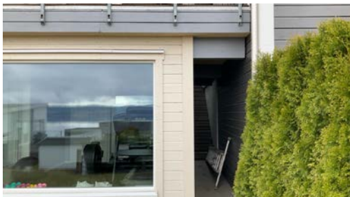
Deler av kledningen mangler overflatebehandling.
