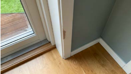
Slitasje på lister.
