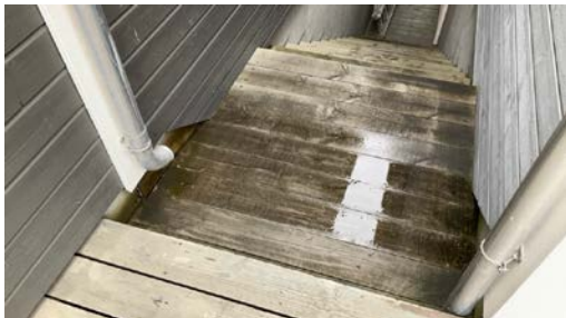
Takvannet ledes ikke vekk fra bygningen.
