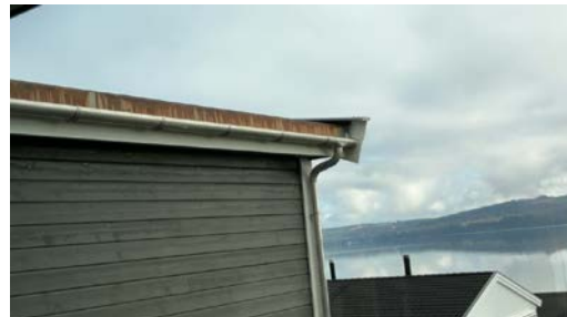
Rust på beslag.
