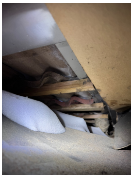
Snø ligger mellom undertaket og taksteinen og var synlig fra området med løse plater.
