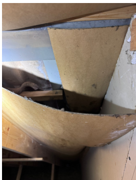
Løs og skadet sutakplate sett fra loftet.
