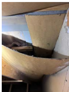
Løs og skadet sutaksplate sett fra loftet.
