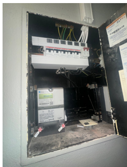
Sikringsskap med automatsikringer.
