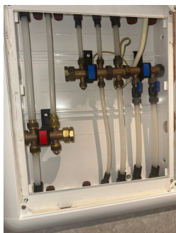
Samleskap med rørkurser og stoppekraner
