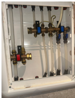
Samleskap med rørkurser og stoppekraner
