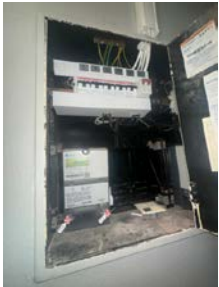
Sikringsskap med automatsikringer.
