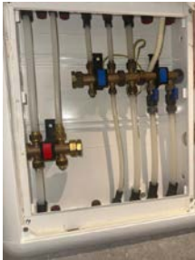
Samleskap med rørkurser og stoppekraner
