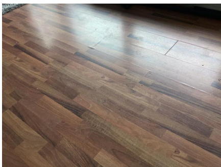
Laminatgulv med fuktskade.
