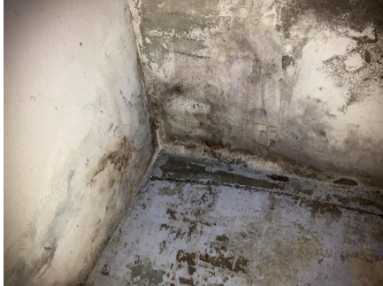
Saltuslag og fuktig grunnmur / gulv.
