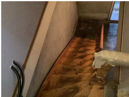
Trapp mangler håndløper.
