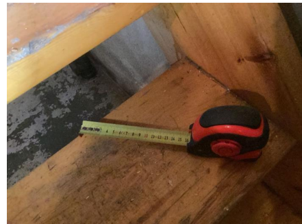
Åpning mellom trinn ca 16 cm.
