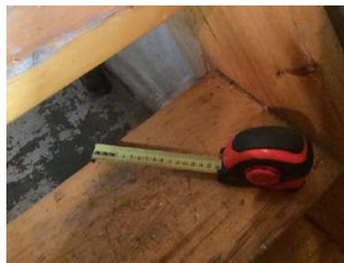
Åpning mellom trinn ca 16 cm.
