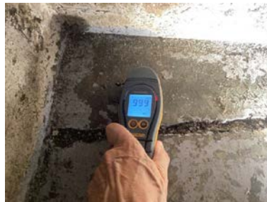
Ved enkle fuktsøk ble det registrert områder med unormale verdier.
