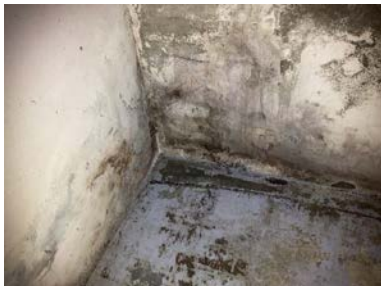
Saltuslag og fuktig grunnmur / gulv.
