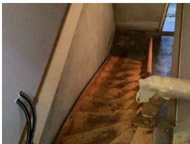
Trapp mangler håndløper.
