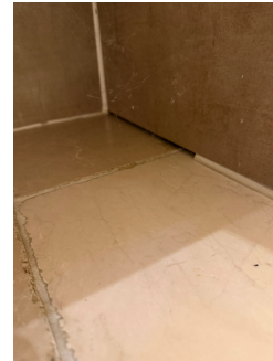
Avrenningsspalte fra innkassing for rør-opplegg og bereder.
