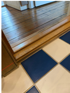
Det er målt under 25 mm. fra overkant sluk, og til membran ved dør.
