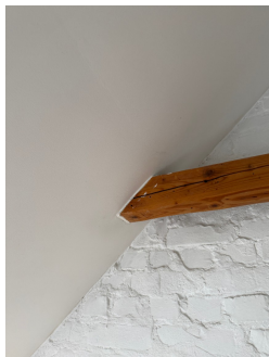
Takbjelke ført igjennom takoverflate/diffusjonssperre.
