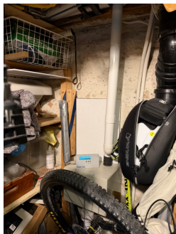
Radonutsug plassert i bod i kjeller-
