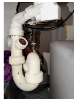
Rør opplegg inne i vegg bak kjøkkeninnredning.
