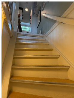
Manglende håndløper. Bratt trapp til kjeller.
