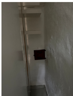
Kort avstand fra feieluke og til brennbart materiale.
