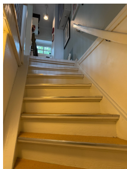
Manglende håndløper. Bratt trapp til kjeller.
