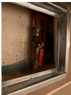
Stoppekran i bad i kjeller. Gamle vann-rør
