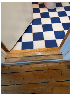
Manglende luftespalte i dør til bad i 2. etg.
