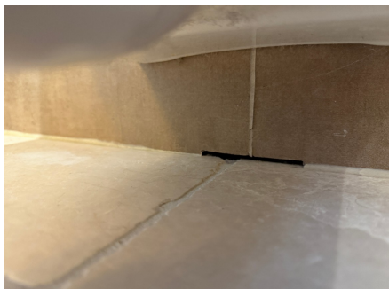
Avrenningsspalte under klosett
