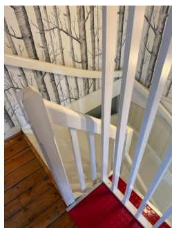
Lav høyde i del av rekkverk på loft.
