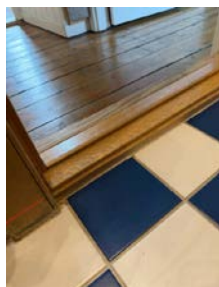
Det er målt under 25 mm. fra overkant sluk, og til membran ved dør.
