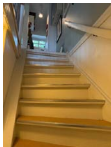
Manglende håndløper. Bratt trapp til kjeller.
