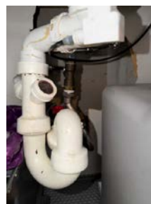
Rør opplegg inne i vegg bak kjøkkeninnredning.
