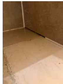
Avrenningsspalte fra innkassing for rør-opplegg og bereder.
