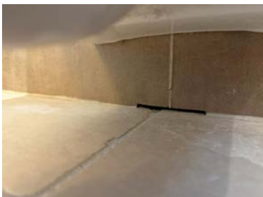
Avrenningsspalte under klosett
