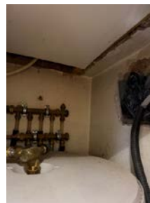
Avtreksventil til luftepipe, er blendet/tettet inne i innkassing.
