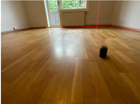
Nivellering stue/kjøkken, avvik ca. 15-30 mm., grener til TG3
