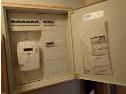
Sikringskap med automatsikringer og automatisk strømmåler.
