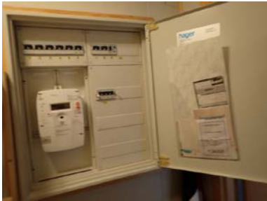
Sikringskap med automatsikringer og automatisk strømmåler.
