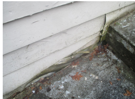
Fuktutsatt punkt i mot veranda.
