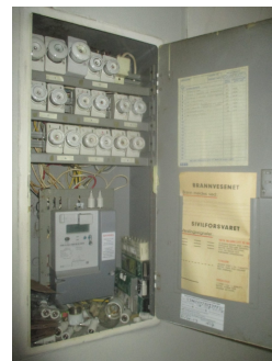
Sikringsskapet i gangen i hovedetasjen.
