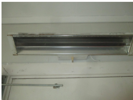
Eldre sråleovn som varmekilde.
