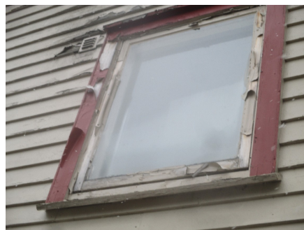
Maling har løsnet på flere vinduer.
