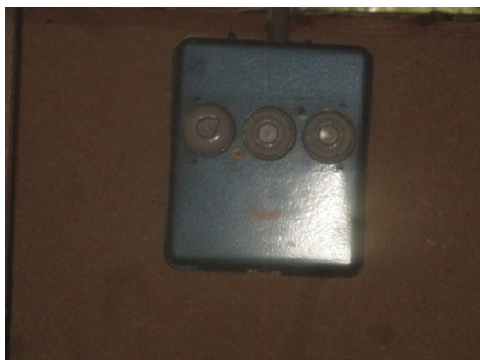
Inntakssikringer på kaldtloftet
