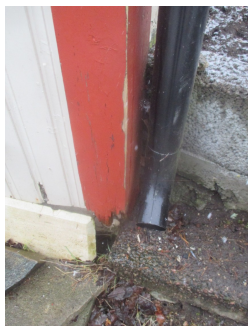
Taknedløp må ledes bort i fra grunnmur.
