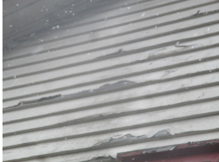
Slitt gavlvegg og maling har løsnet.
