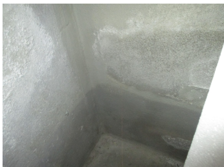
En del saluslag og fuktmerker i nedre del av grunnmur.
