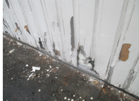
Større råteskader på utfored grunnmur
