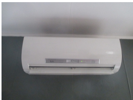
Varmepumpe i stue
