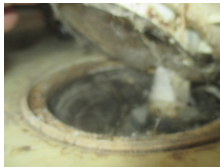
Sluk under dusjkabinett
