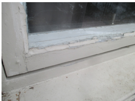
En god del utvendig vedlikehold må beregnes.
