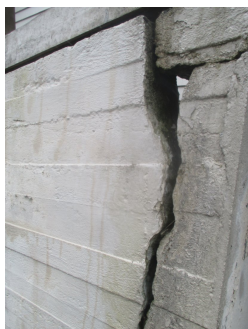
Større sprekke i forstøtningsmuren.
