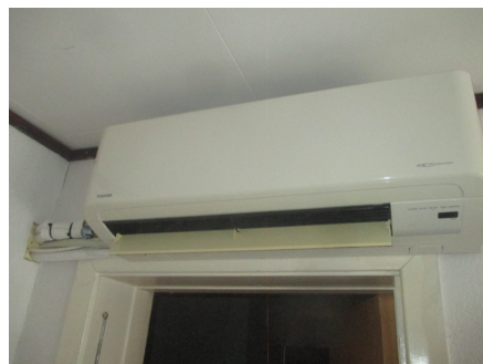
Varmepumpe i kjellerstue
