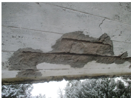
Synlig armeringsjern på undersiden av dekke.
